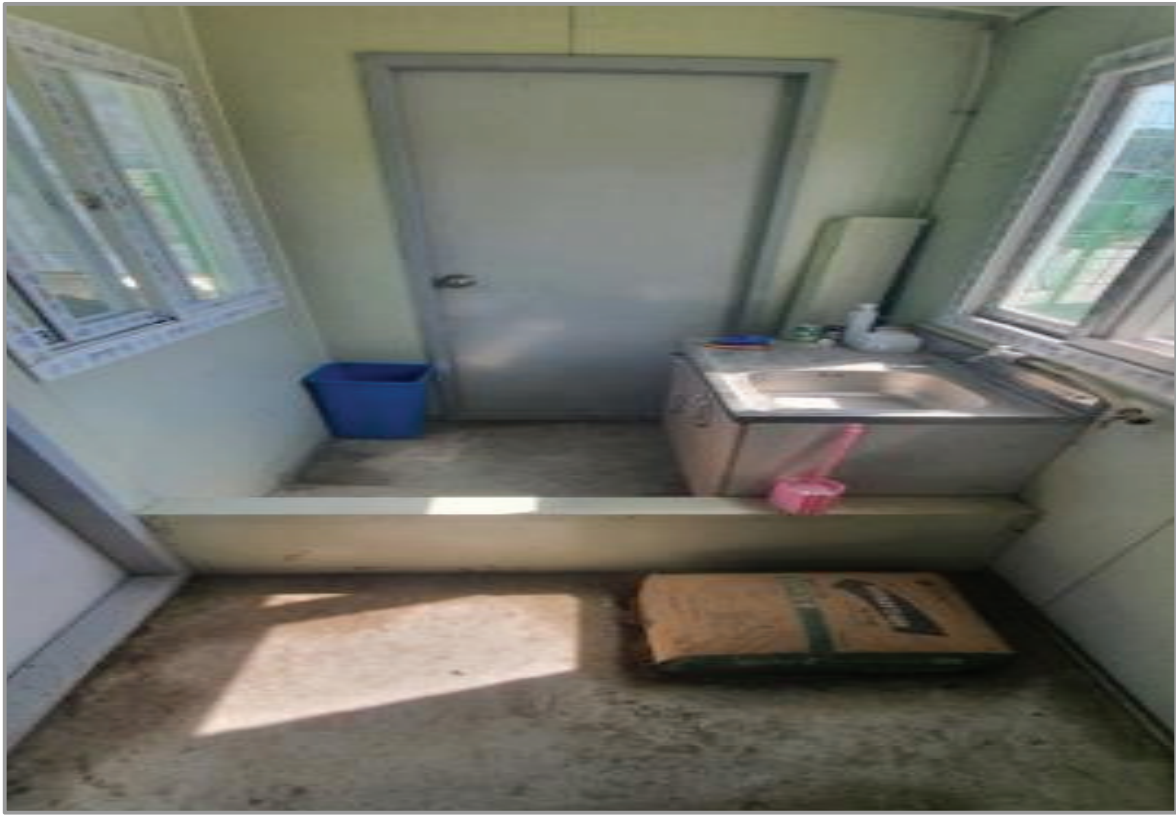
〈돈방 외부전실 설치사례〉 전실 내부 차단벽, 신발장, 장화 등 비치
