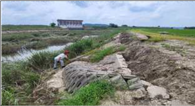
배수로 사면 유실
