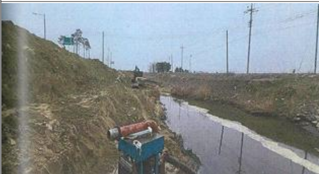
배수로 사면 유실
