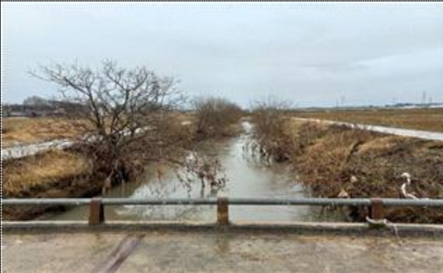
배수로 사면 유실
