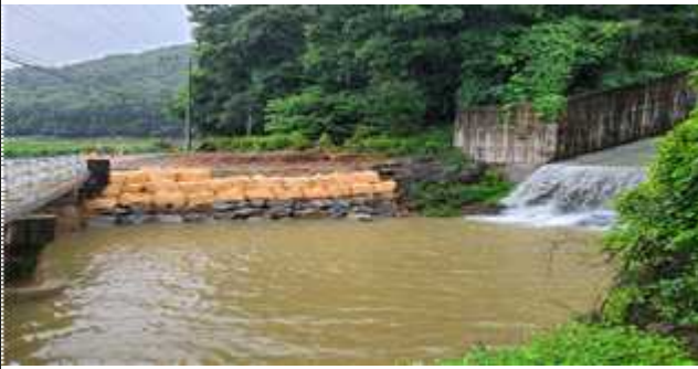
배수로 사면 유실
