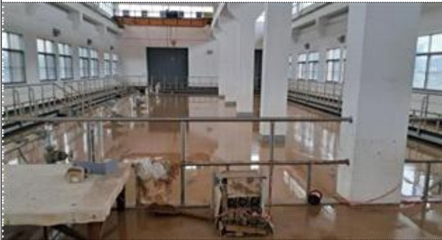
배수장 기계(펌프) 침수
