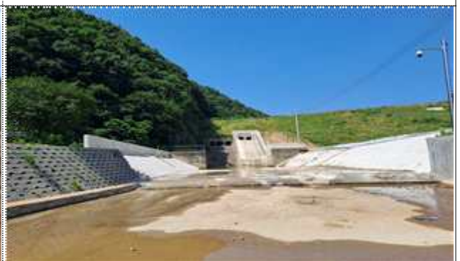
배수로 사면 유실
