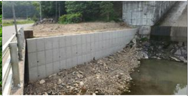
배수로 사면 유실
