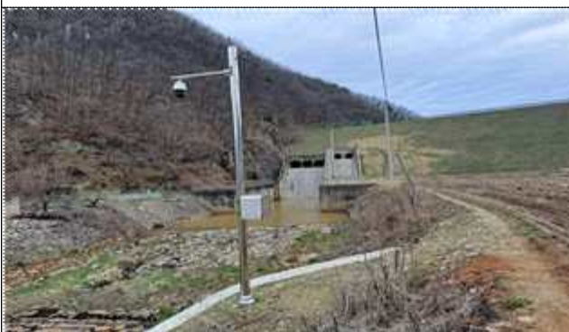
배수로 사면 유실
