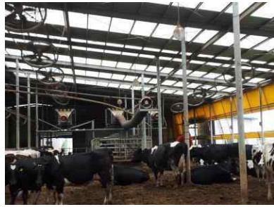
< 우사 송풍팬 설치 >
