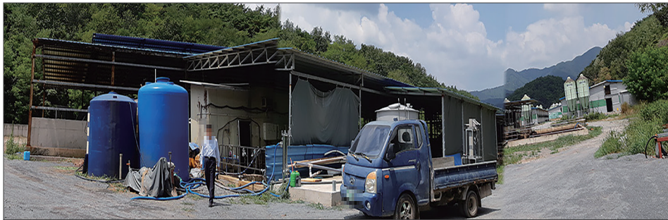
피신청인 세부 시설현황 - 가축분뇨 정화처리시설
