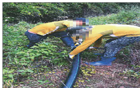
방류수 방류관 설치현황
